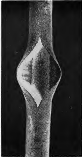
FIG. 10. Tube failure due to analcite scale.
